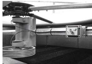
Abbildung 2: Typische 5550-Installation an der Stützstrebe des Kühlturmlüfers.
